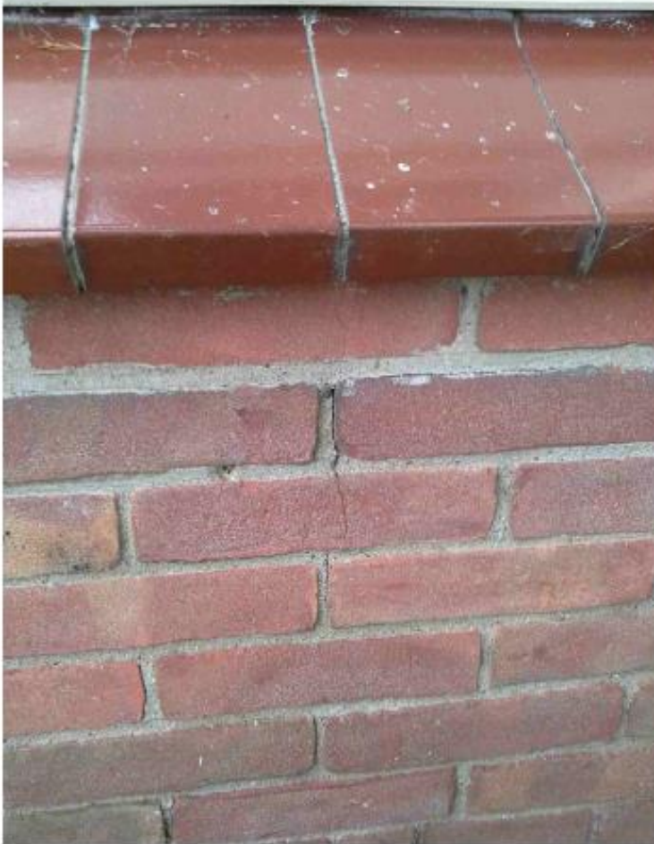
Woning, Voorgevel: Scheur, (licht 0 - 2 mm, verticaal)
